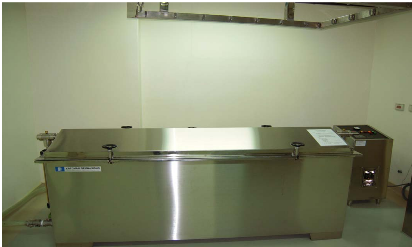
大體浸泡室(大體急速防腐)
